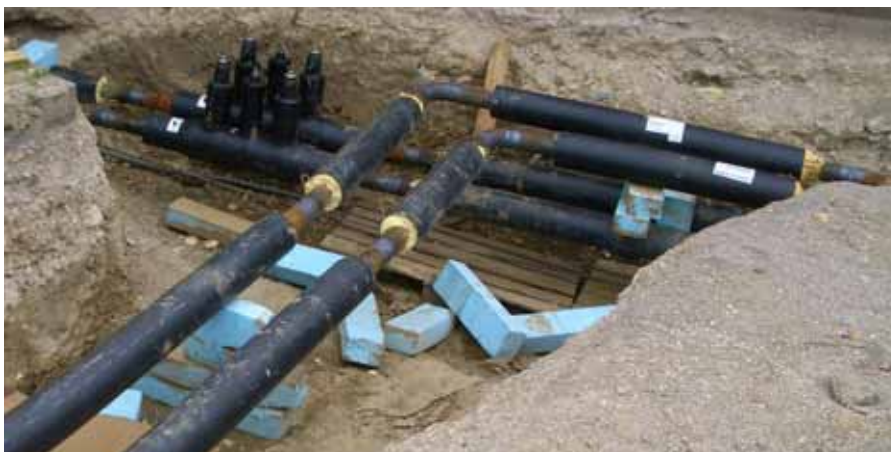
Wärmeverteilnetze sind eine der kostenintensivsten Bestandteile der Energieversorgungsanlagen
